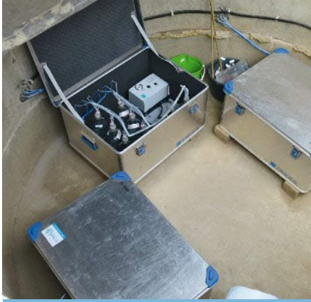
Messtechnik in einem Schacht
